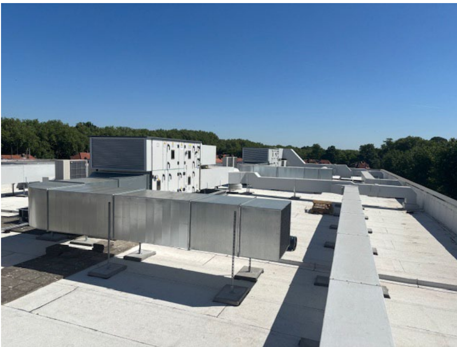
Kanalen en luchtbehandelingskasten
